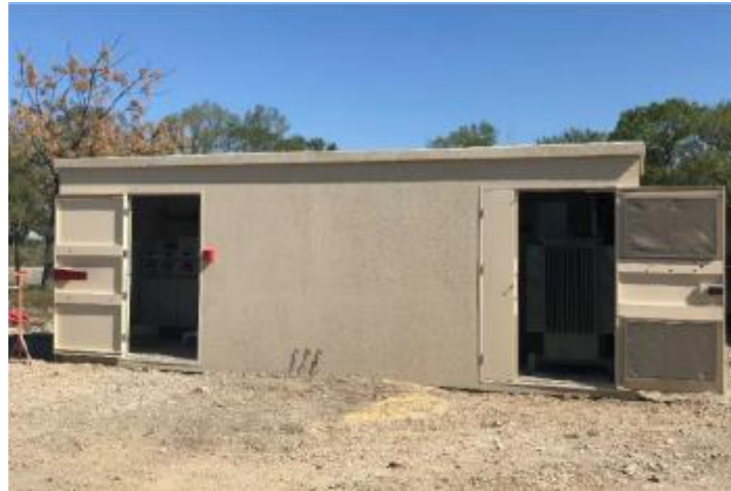
Figure II-14 : Photographie d'un poste de livraison/transformation – source : VALECO
