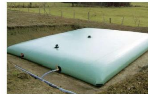
Figure II-15 : Exemples de réserve d'eau artificielle pour la défense incendie – source : VALECO
